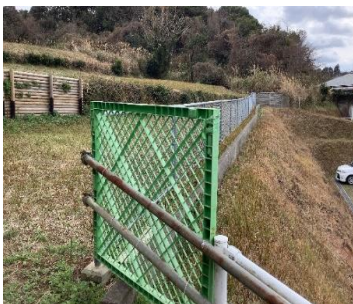
フェンスぐらつきが有り 令和6年6月8日に工事しております。
