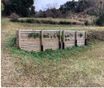
石垣が大雨の影響で崩れた為 令和5年11月12日工事しております。
